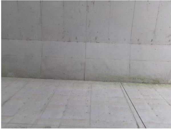
동진2교 바닥판하면 S4 0.3/3.0*4(A2)
