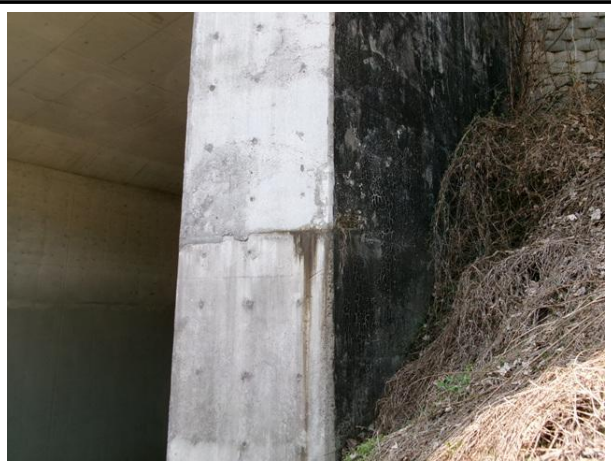
동진2교 교대 A2측 재료분리 0.2*0.5, 파손,철근노출 0.2*0.5
