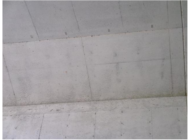
동진2교 바닥판하면 S5 0.3/3.0*4(A1)
